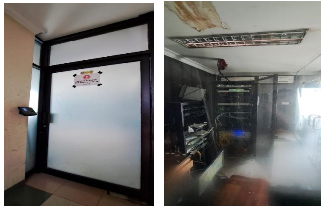
Gambar 1.3 Pintu dan di dalam ruangan server belum terpasang CCTV
